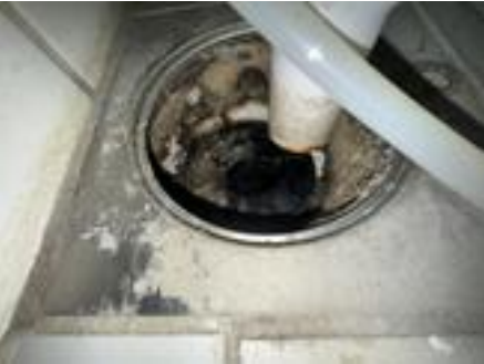
Sluk under dusjkabinett
