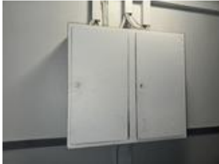
Sikringsskap i felles trappeoppgang. (ikke tilgang på befaringtidspunkt)
