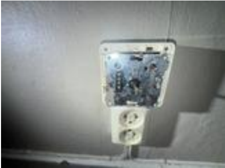
Stue: Dimmer mangler deksel
