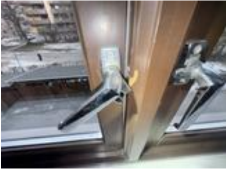
Skrapemerke ved vrider på soveromsvindu
