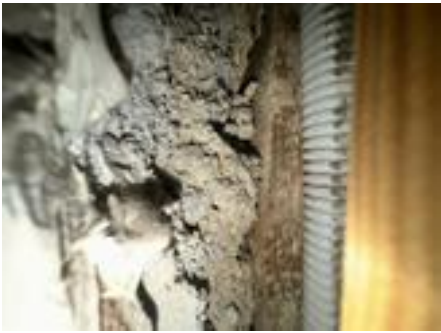
Hull i fliser bak servantskap/dør.
