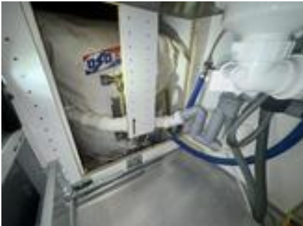
Varmtvannsberder i hjørnet under kjøkkenbenk
