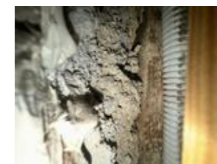
Hull i fliser bak servantskap/dør.
