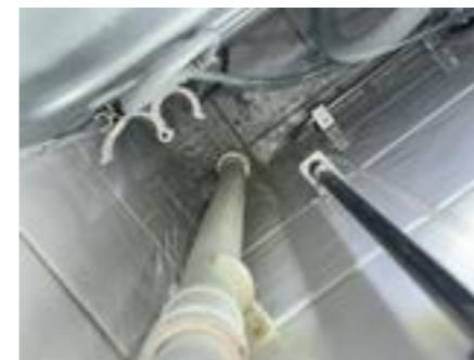
Avløpt fra vaskemaskin
