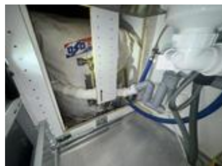
Varmtvannsbereider i hjørnet under kjøkkenbenk
