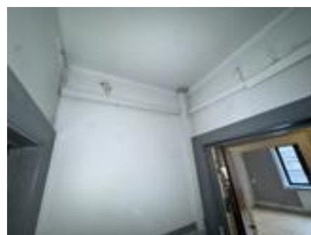
(Felles gang): Løse ledninger uryddig opplegg, utenfor inngangsdør
