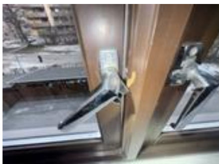
Skrapemerke ved vrider på soveromsvindu
