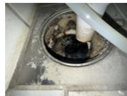
Sluk under dusjkabinett
