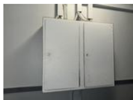
Sikringskapp i felles trappeoppgang. (ikke tilgang på befaringstidspunkt)
