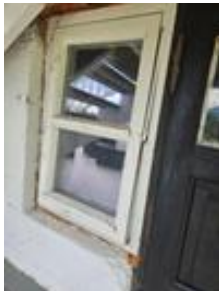
Kjellervindu. Ikke innpusset, ikke montert beslag i underkant
