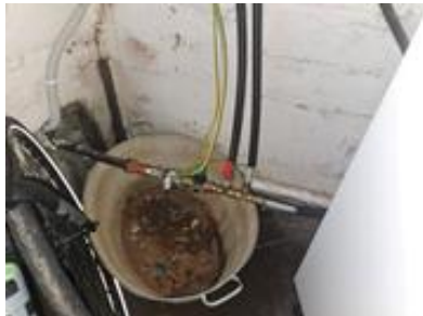
Stoppekran og reduksjonsventil for vann, i kjelleren
