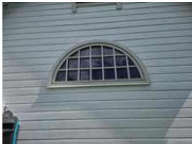
Buet vindu i fasade vest
