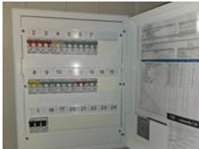
Sikringsskap med automatsikringer og kursfortegnelse
