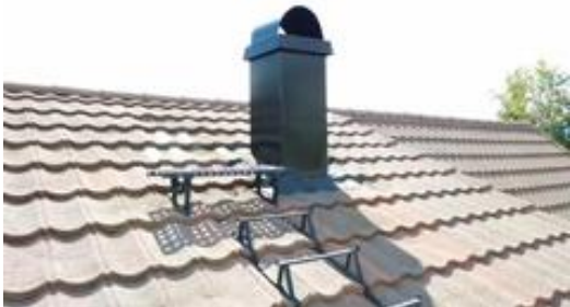
Pipetrekk og feieplattform
