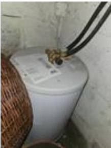
Varmtvannstank ca 45 liter i kjelleren
