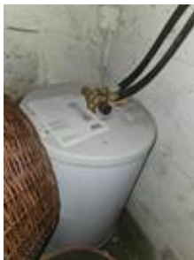
Varmtvannstank ca 45 liter i kjelleren
