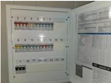
Sikringsskap med automatsikringer og kursfortegnelse
