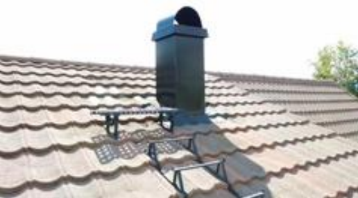
Pipetrekk og feieplattform
