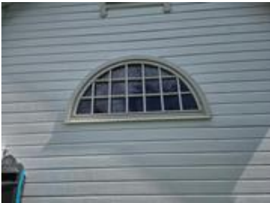
Buet vindu i fasade vest
