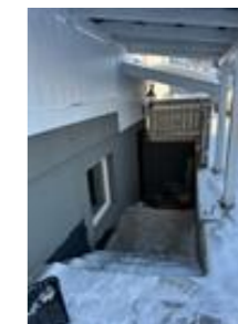
Mangler rekkverk som sikring for fall.
