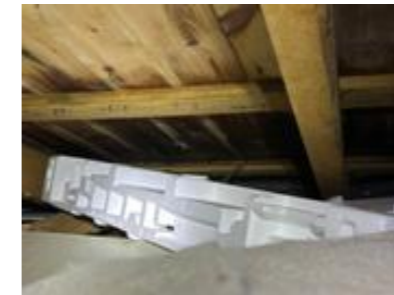
Fukt gjennomslag i undertaket.
