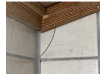
Sprekk i flis i våtzone.
