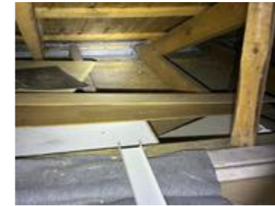
Frost gjennomslag på loftet.
