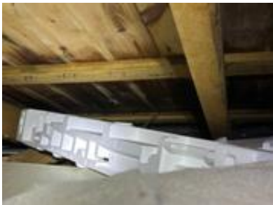
Fukt gjennomslag i undertaket.
