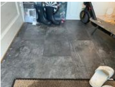
Svelleskader på laminat gulv i entre.
