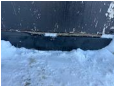
Feil montert beslag under ytterdør.
