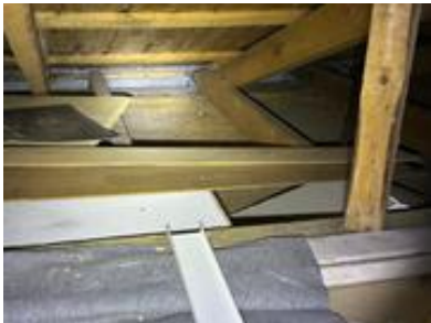
Frost gjennomslag på loftet.
