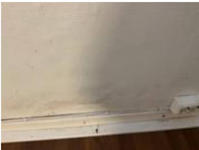
Skade i vegg under terreng.
