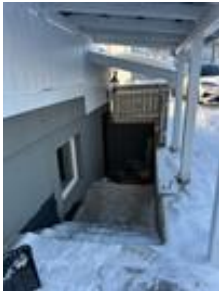
Mangler rekkverk som sikring for fall.
