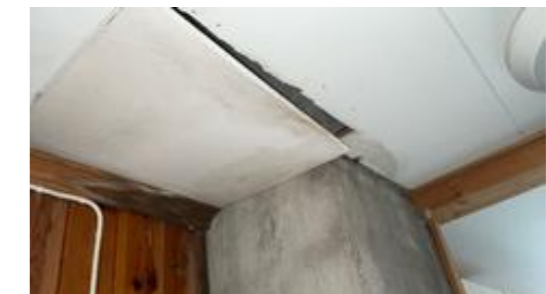
Merke etter fukt på innvendig tak på kjøkken.
