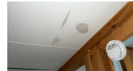
Merke etter fukt på innvendig tak i gang.
