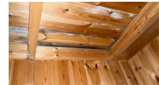
Fuktskader på innvendig tak over soverom mot nord.
