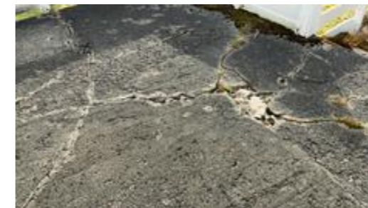
Støpt dekke på terrasse har sprekker.
