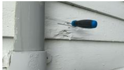
Punktråte i kledning fasade sørøst
