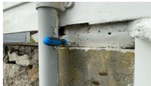
Punktråte i bunnstokk på mur på hjørne mot sør. Bunnstokken er ikke kledd inn.
