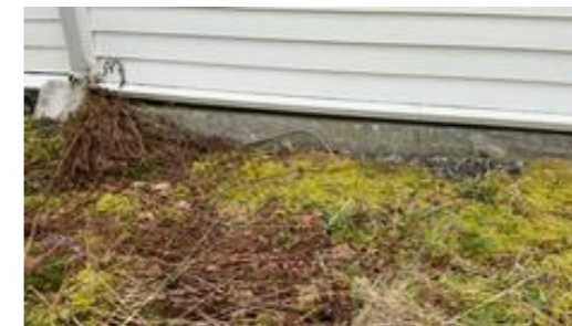
Deler av grunnmur mot nordøst har seget.
