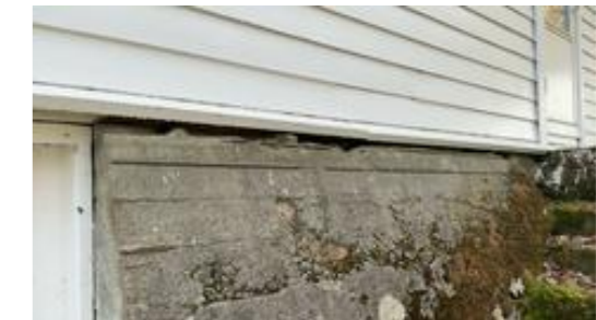
Deler av grunnmur mot nordøst har seget.
