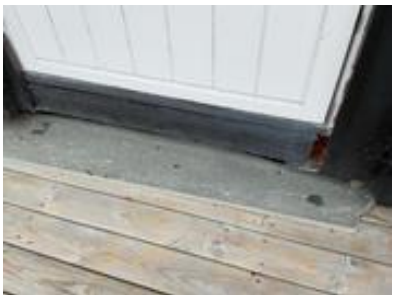
Dårlig beslag balkongdør annekset.
