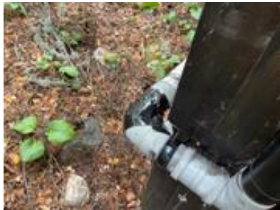
Ufagmessig skjøttet drensrør, med teip.
