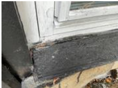
Dårlig overgang vannbord og vindu.
