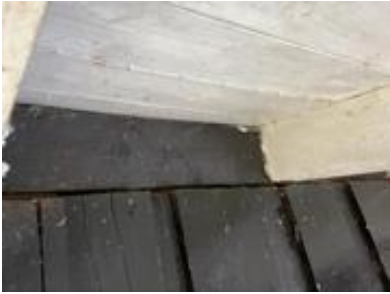
Ingen lufting gesims.
