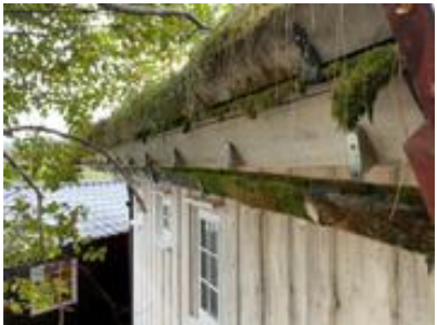
Dårlig funksjon takrenner i tre.
