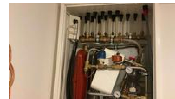
Rør i rør.
