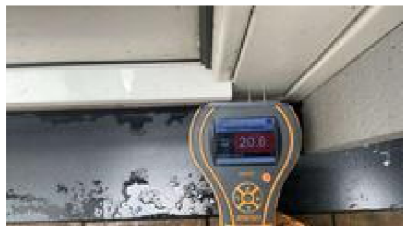
Høytfuktnivå i balkongdør
