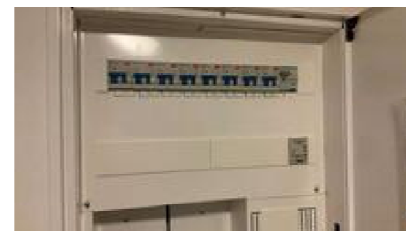
Sikringskap med automatsikringer.
