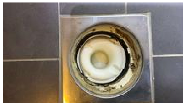
Sluk med synlig membran.
