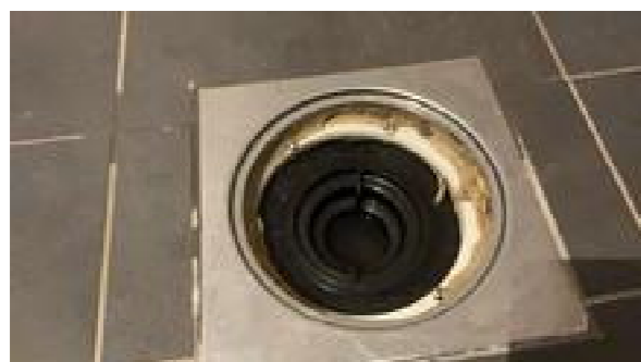
Sluk med synlig membran.
