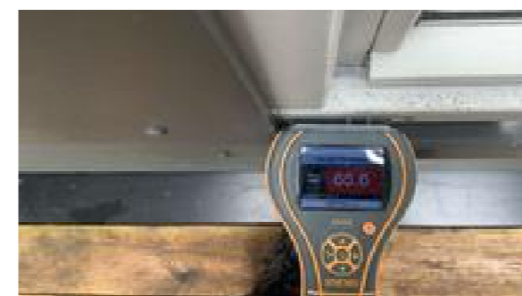
Høyt fuktnivå i vindu.
