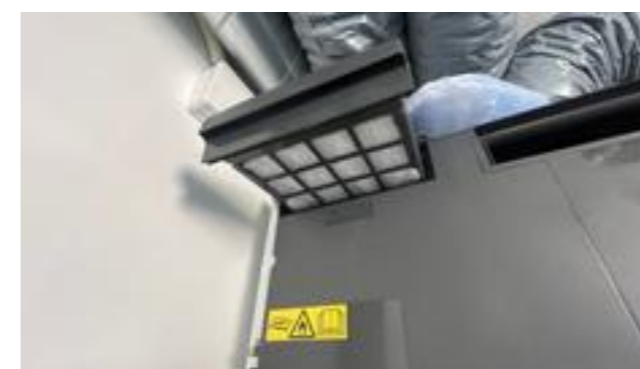
Sjekk av filter i ventilasjonsanlegg.
