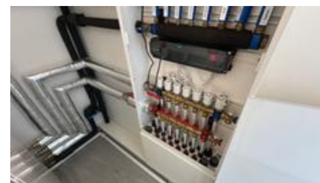
Rørkurser til varmeanlegg i teknisk rom/skap.
