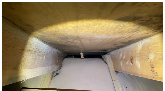
Tredd lekte ned mellom isolasjonen og undertak.
