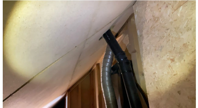
Utlufting av avløpsanlegget sett i knekott.
