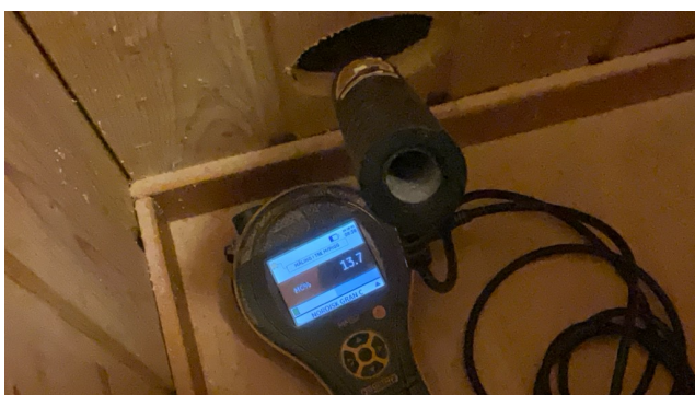
Fuktsøkt i påforet yttervegg uten unormale forhold.
