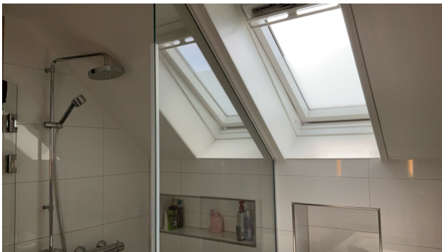
Vindu plassert i dusjens fuktsone.
