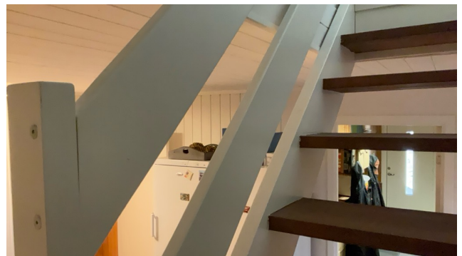
Større åpninger mellom trinn og i rekkverk i trapp.
