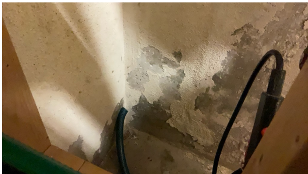
Salt/kalkutslag og malingsavflassing på overflater mur i kjeller.
