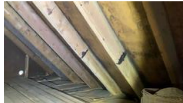
Svertesopp på undertak/sutak.
