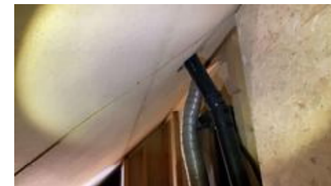
Utlufting av avløpsanlegget sett i knekott.
