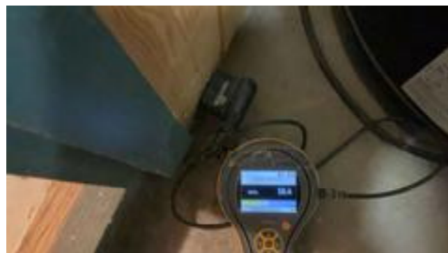
Fuktsøkt i trekonstruksjoner på vaskerom i risikosone.
