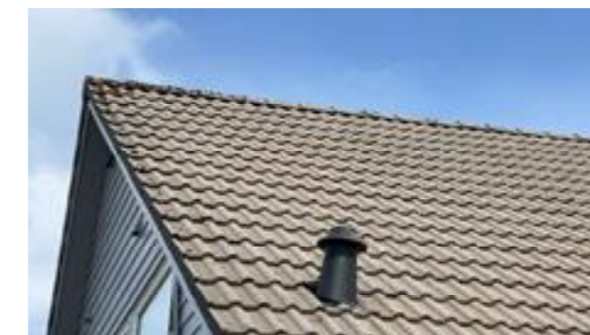
Noe mose på overflater takstein.
