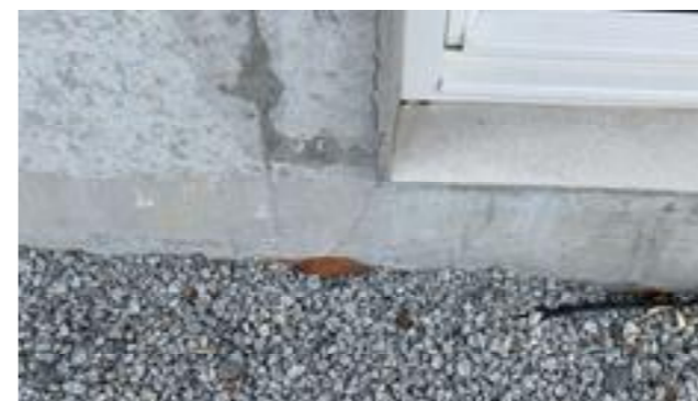
Enkelte riss i mur.
