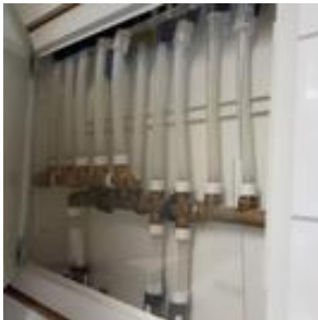
Fordelerskap i vaskerom.
