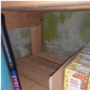
Sprekker i mur på bod mot nordøst.
