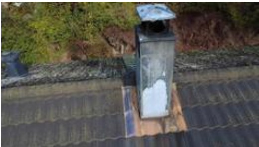
Avskalling på pipebeslag.
