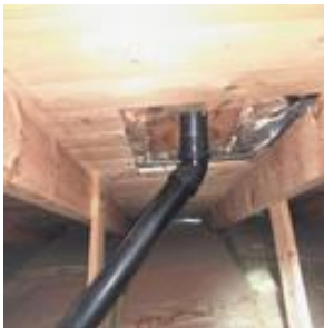
Fuktmerker rundt takhatt og på isolasjon under.
