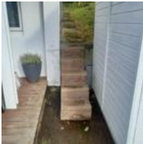
Sprekker i mur, bilde mot sydøst.
