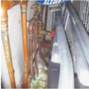
Eldre kobberør. Bilde er tatt i bod i hybel.
