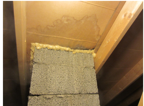
Ved pipe er det teikn på fukt frå tidlegare lekkasje. Sjå punkt ang. pipehatt.
