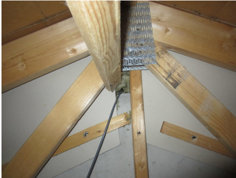
Brannvegg er punktert
