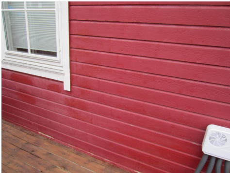
Generell slitasje på vegg.
