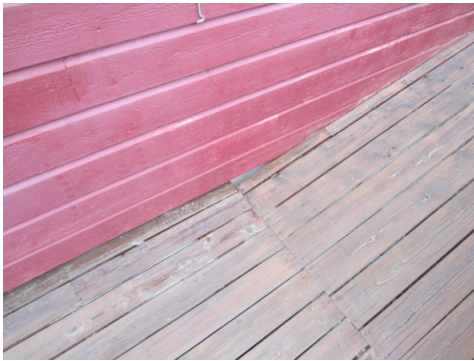
Dels tetta lufting, ikkje beslag mellm altan og vegg
