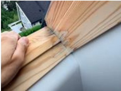
Eksempel på fuktmerker på vinduskarm takvindu.
