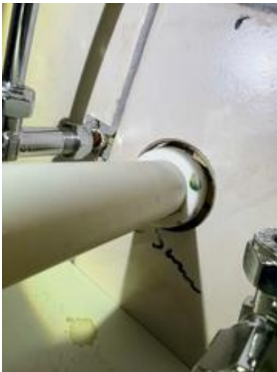
Utett rørgjennomføring i vegg under servant.
