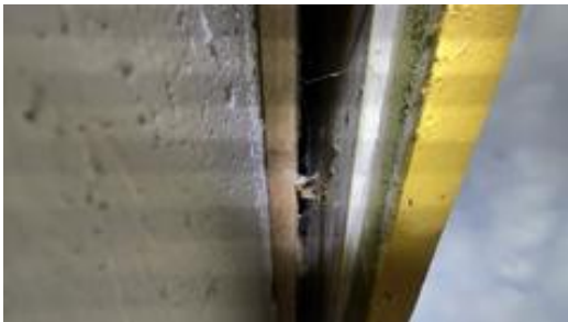
Det er ikke montert musebånd/musetetting bak kledning.
