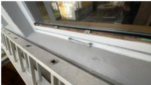
Vindu i underetasje mangler utvendig beslag.
