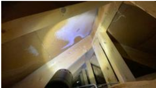
Rim i innvendig sutak på loft.
