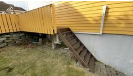
Utvendig tretrapp mangler rekkverk.
