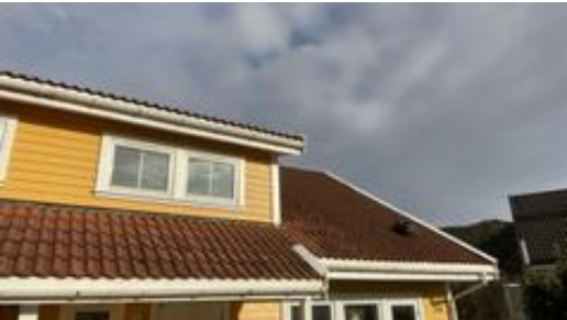
Det er ikke montert snøfangere på tak.
