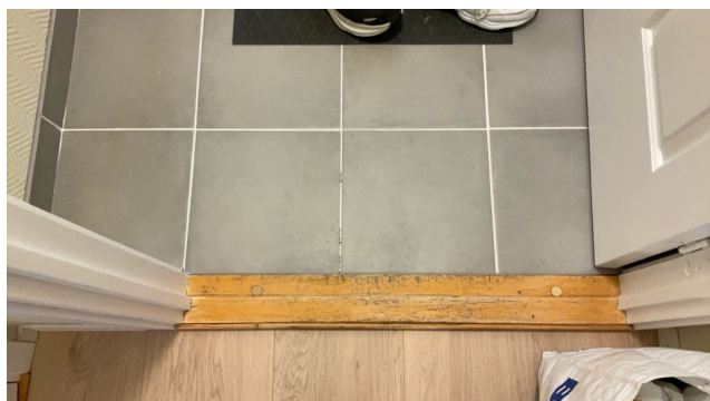
Fliser i entre med knikk/bom under.
