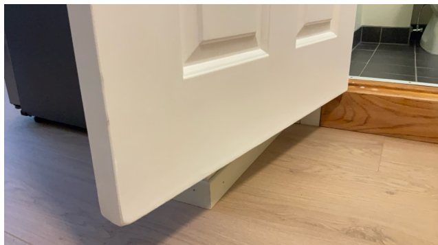
Fuktskader/svellinger i nedre kant dørblad.
