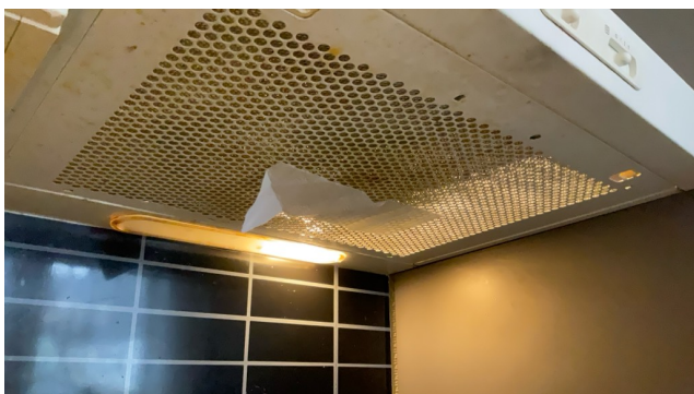
Ventilator funksjonstestet med papir.
