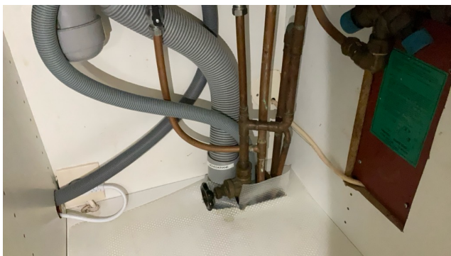
Vannledninger av kobber, med med stengekran på vann.
