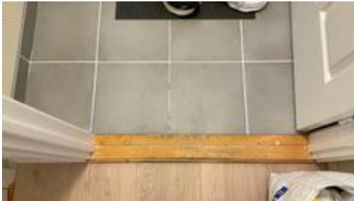
Fliser i entre med knikk/bom under.
