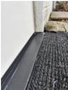
Beslag under ytterdør har ikke fall ut/fra, er ikke festet mot underlaget.
