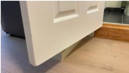
Fuktskader/svelling i nedre kant dørbblad.
