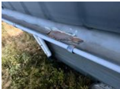
Rust i takrenne.
