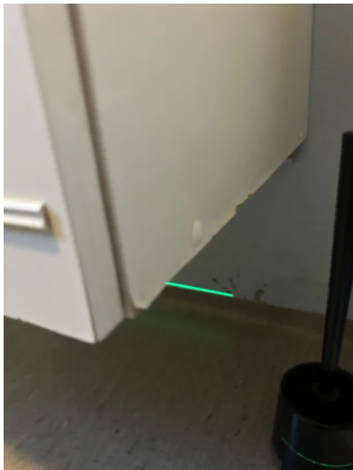
Fuktskader på baderomsinnredning.
