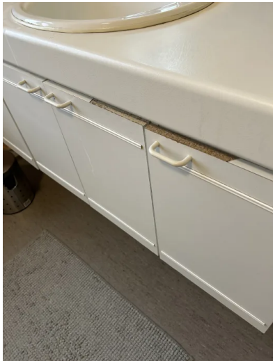
Skade på baderomsinnredning.
