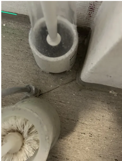
Ufullstendig skjøt i gulvbelegg.
