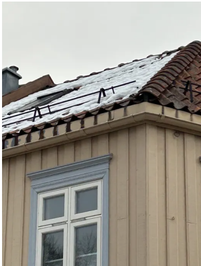
Begynnende rust i takrenner.
