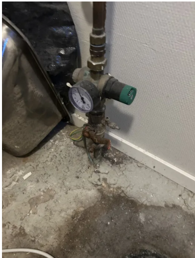
Eldre stoppekran. Ikke funksjonstestet pga alder og fare for lekkasjer. Anbefales skiftet.
