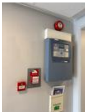
Felles brannvarslingsanlegg i bygget
