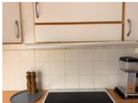
Ventilatoruttrekk er skjevt.
