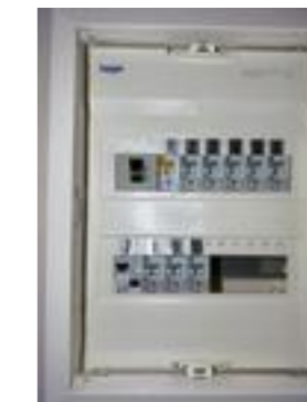
Automatsikringer med skap i entre.
