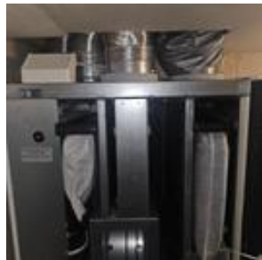
Balansert ventilasjon med varmegjenvinner
