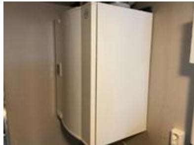
Balansert ventilasjon med varmegjenvinner
