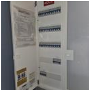
Sikringsskap med automatsikringer og kursfortegnelse
