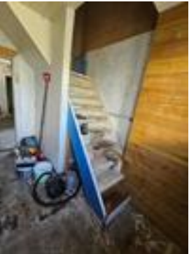
Trappen til underetasjen mangler rekkverk og håndrekke
