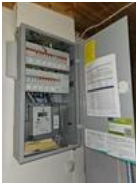
Sikringsskap med automatsikringer
