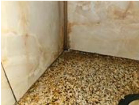
Fukt / råteskade i dusjen
