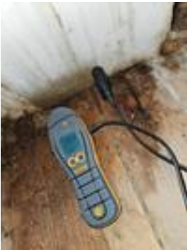
Høyt fuktinnhold i gulvet ved pipen
