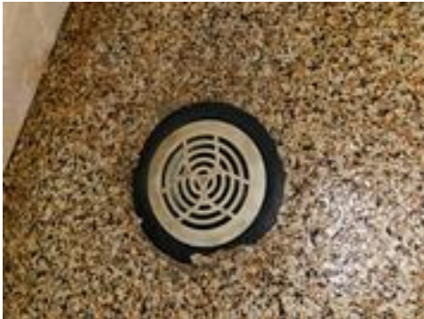
Plastsluk i gulvet
