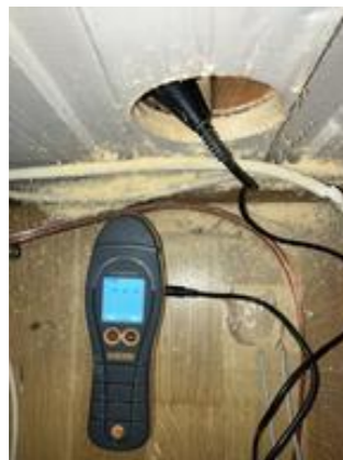
Bilde av fuktsøk via hulltaking uten at det påvises skadelig fukt i organisk materiale.
