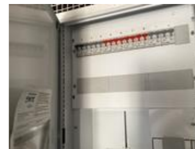
Bilde av sikringskap.
