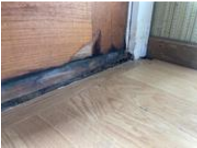
Ytterdør med råte/skade
