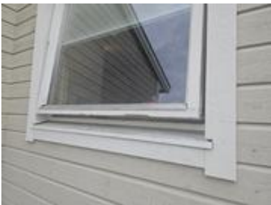
Noe slitasje på enkelte vinduer
