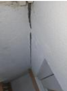
Sprekk mellom utvendig trapp og grunnmur, bilde tatt fra undersiden
