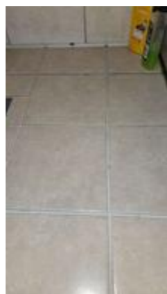
Sår i fuger og litt svertesopp i silikonfug.
