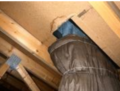
Gamle, tørre fuktmerker rundt gjennomføring ventilasjonsgjennomføring i taket.
