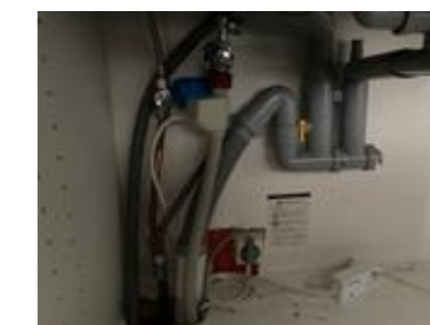
Røropplegg i skap under vask
