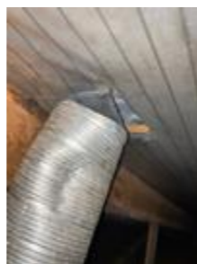
Kanal fra ventilator på kjøkken
