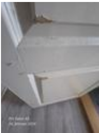
Det er registrert fuktskade på badedør.
