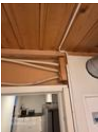
Det er registrert noe manglende ferdigstillelse i underetasjen.
