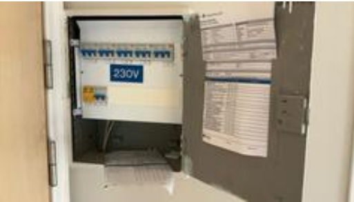
Sikringskap med automater.
