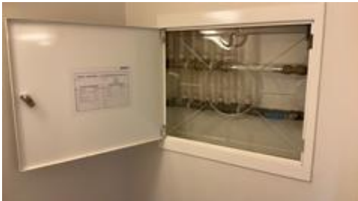
Vannfordelingsskap for rør i rør
