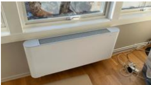
Varmekonvektor i stue.
