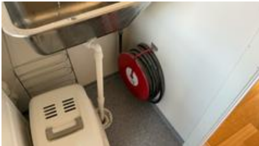
Husbrannslange på vaskerom.
