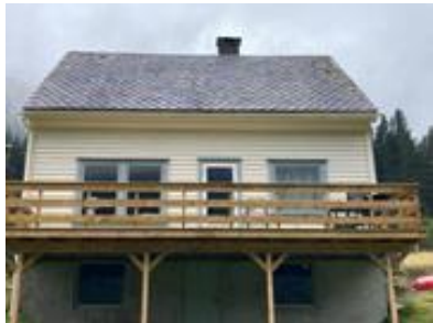
Mangler skiferhelle på tak
