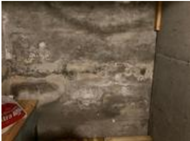
Saltutslag i murer
