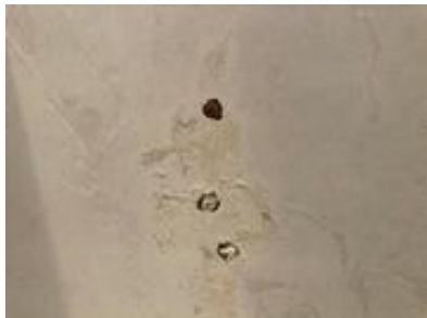
Merker etter tidligere installasjon
