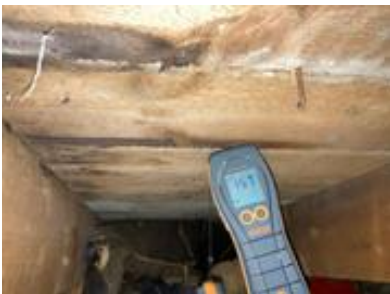
Målt fukt i sutak
