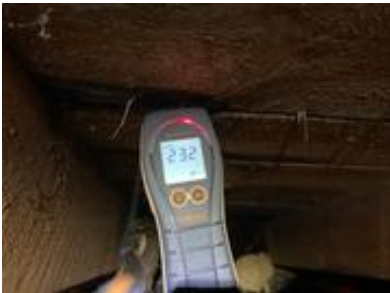
Målt fukt i sutak
