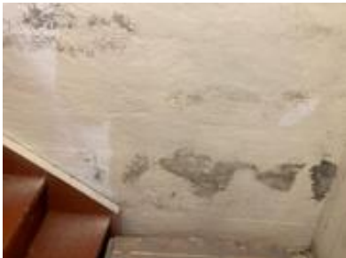
Saltutslag i murer
