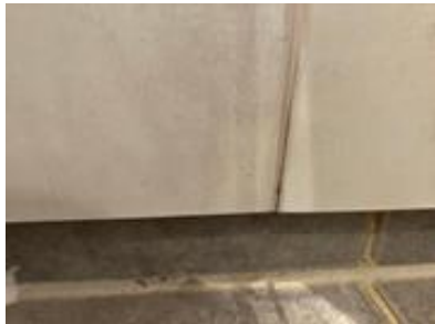
Skade i nedre del av plate i dusjsone
