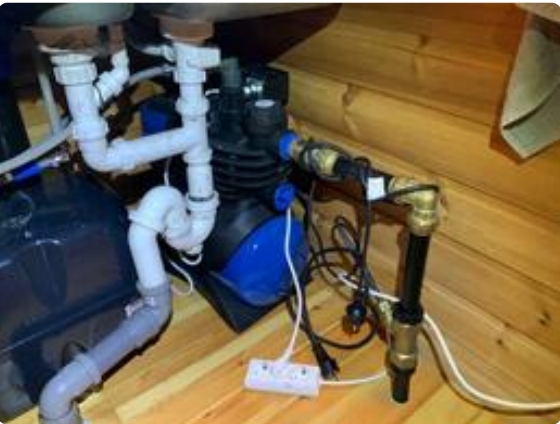
Vanninntak, avløp og vannpumpe.
