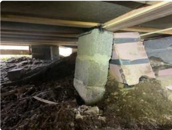
Eksempel på skjevheter i pilarer
