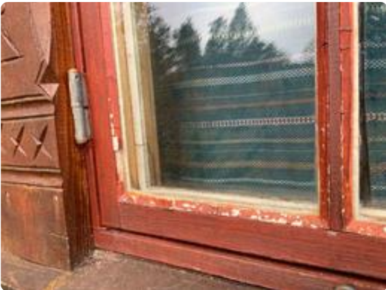
Sprekker og avskallet kitt
