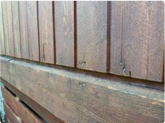
Tørkesprekker og vedlikeholdsmangel
