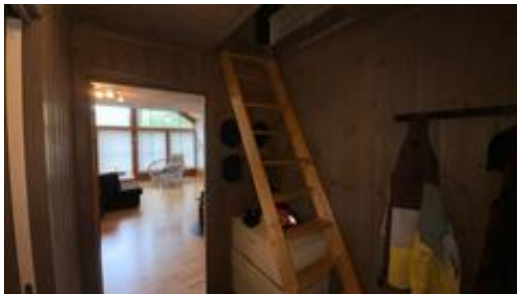
Trapp mangler rekkverk.
