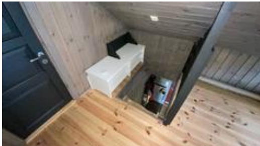
Rekkverk mangler på en av sidene.
