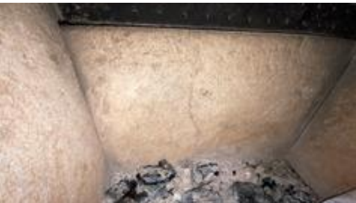
Sprekk i ildstein til vedovn.
