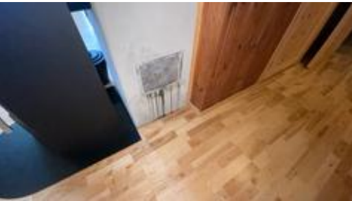
Sotrenning fra feieluke, samt avstand til vegg er mindre enn 300mm
