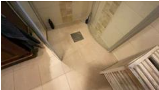
Ikke tilstrekkelig fall i dusjnisjen
