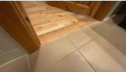
Ingen oppbrett av membran mot terskel
