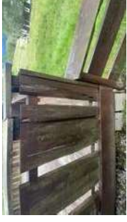
Råteskadet bord til rekkverk.
