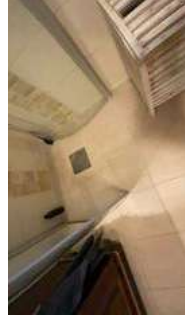
Ikke tilstrekkelig fall i dusjnisjen
