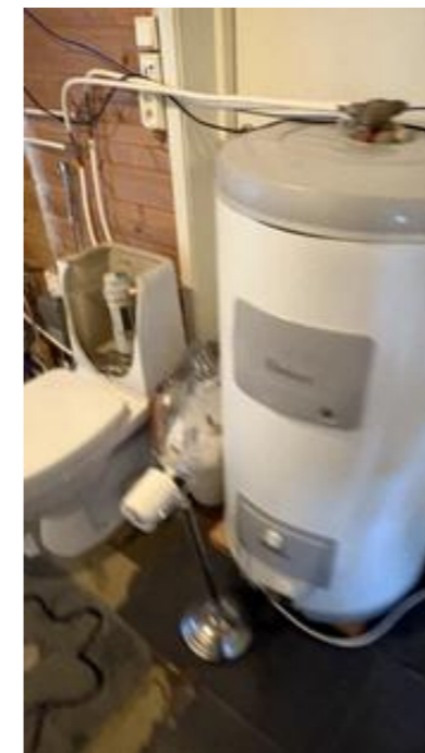
På bildet kan man se fuktmerker på gulvet etter lekkasje fra bereder.
