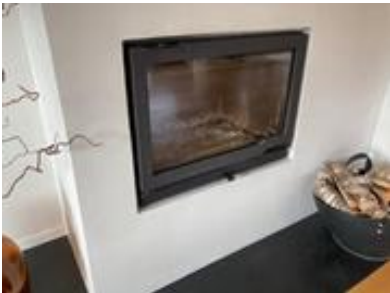
Vedovn i 1. etasje
