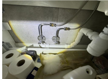
Tette gjennomføringer under servant.
