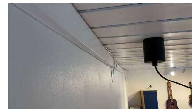
Synlig sig/svank i takkonstruksjonen.
