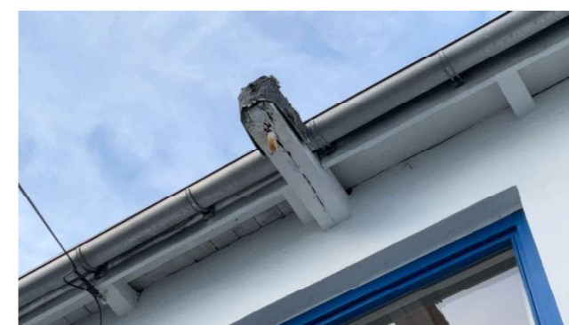
Råteskade på takutstikk/bjelke med krok.
