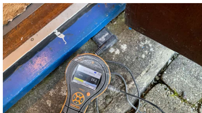
Høy trefukt i terskel/belistning.
