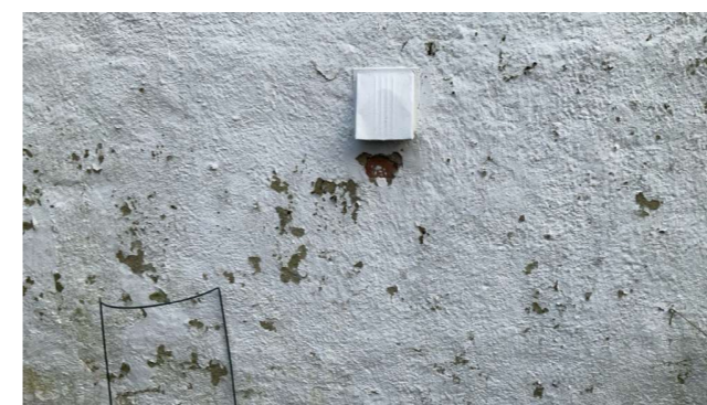
Avskallinger sett på bakside.
