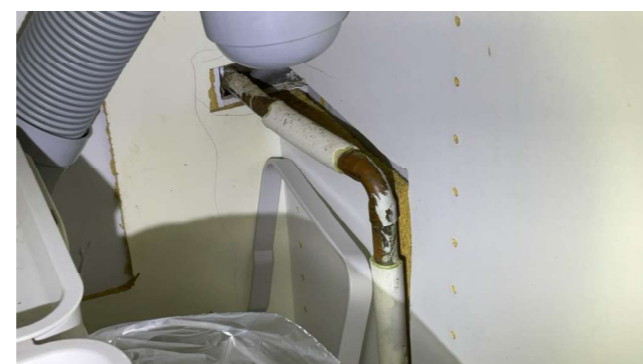
Vannledninger av kobber.
