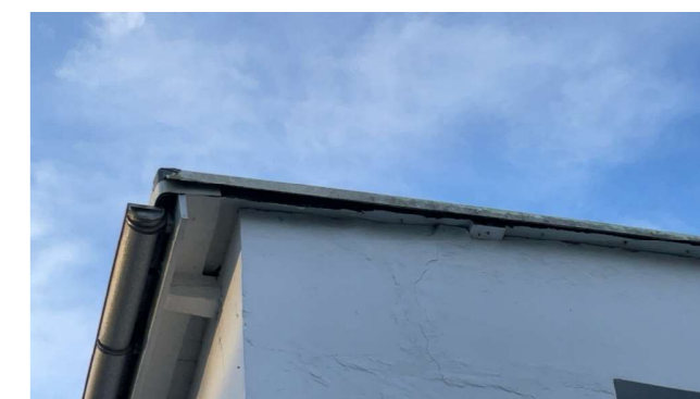
Undertak med råteskade.
