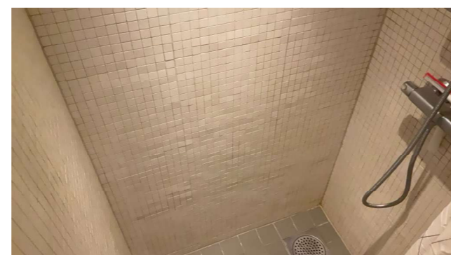
Fliser på vegg med ugjevne overflater.
