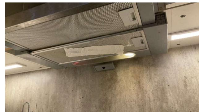
Ventilator funksjonstestet med papir.
