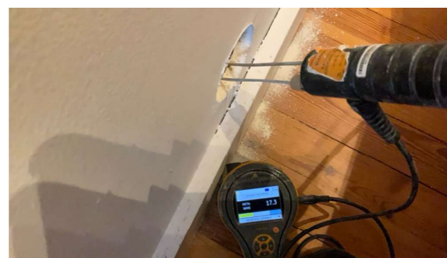
Fuktmålt i trekonstruksjon i risikosone.
