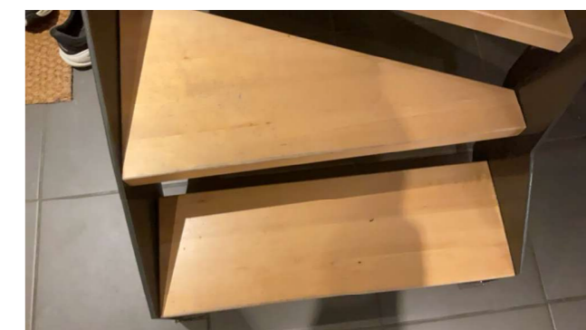
Bruksslitasjer på trinn
