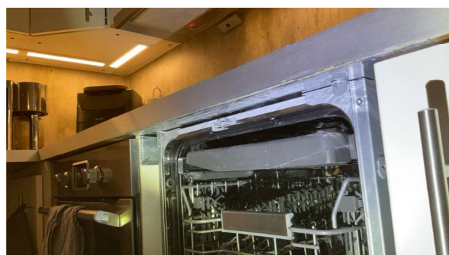
Fuktskader/svellinger framkant benkeplate.
