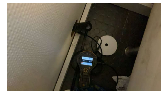
Påforet vegg i soverom med for høy trefukt
