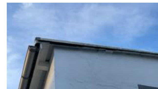
Undertak med råteskade.
