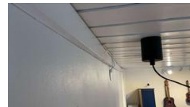
Synlig sig/svak i takkonstruksjonen.
