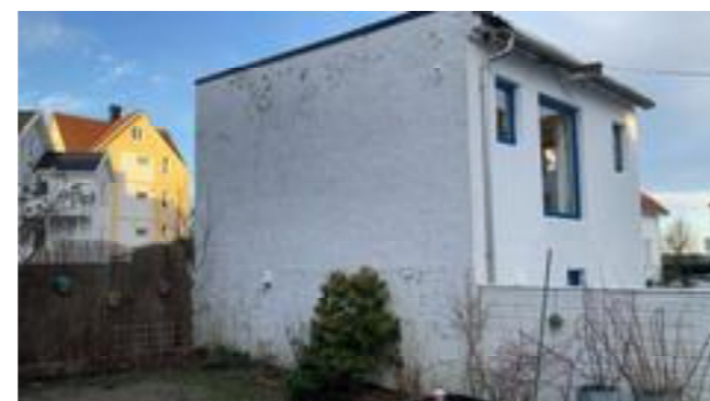
Avskallinger på fasade mot tilstøtende tomt.
