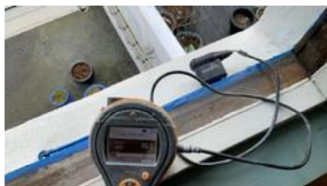
For høy trefukt i vinduer.
