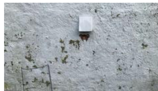
Avskallinger sett på bakside.
