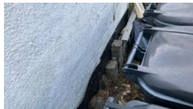
Platonplast på mur, ikke brukt platonlist på toppen av platen.
