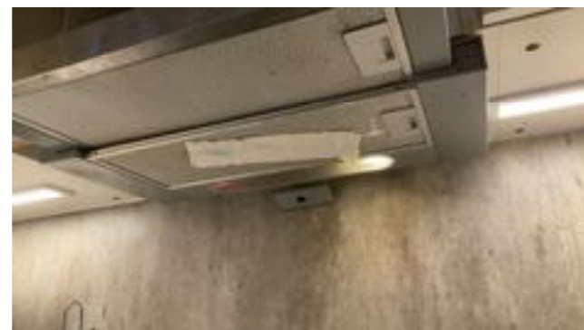
Ventilator funksjonstestet med papir.
