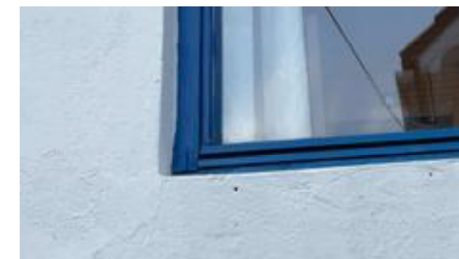
Råteskader på vinduer.
