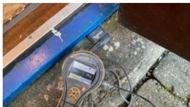
Høy trefukt i terskel/belistning.
