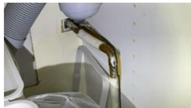
Vannledninger av kobber.
