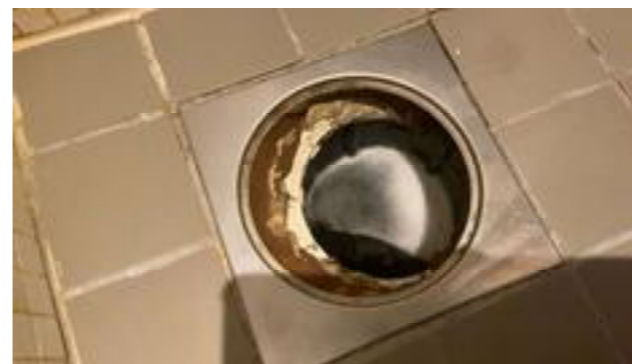
Sluk i gulv.
