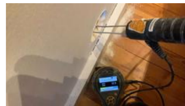
Fuktmålt i trekonstruksjon i risikosone.
