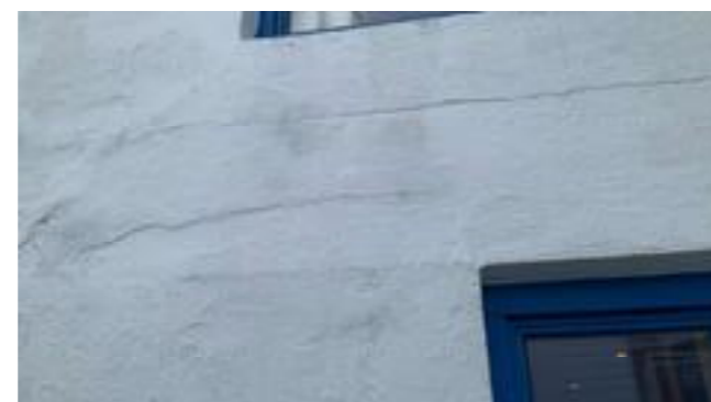
Sprikker og riss i overflater.
