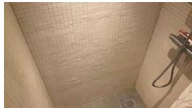
Fliser på vegg med ugjevne overflater.
