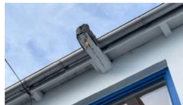
Råteskade på takutstikk/bjelke med krok.
