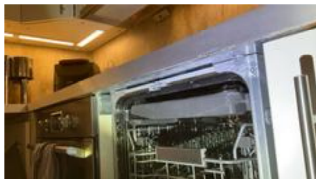
Fuktskader/svellinger framkant benkeplate.
