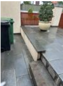
Utvendig støttemur krever rekkverk for å unngå fallulykker.
