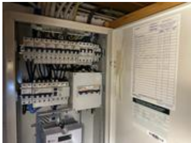
Sikringsskap i kjeller med hovedsikringer. Det er jordfeilbrytere i begge skapene.
