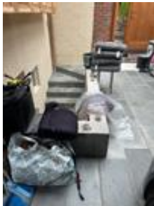
Mur/rekkverk på kjellertrapp i garasje tilfredsstillr ikke krav til høyde
