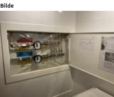
Fordelerskap med stoppekran.
