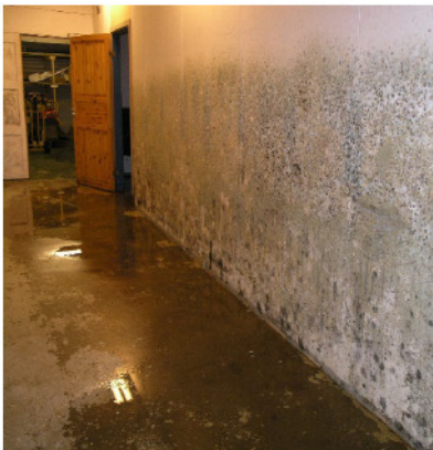
Muggsoppvekst som følge av vannskade
