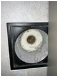
Hjelpesluk på gulv, synlig membran, men ikke klemt under klemring.
