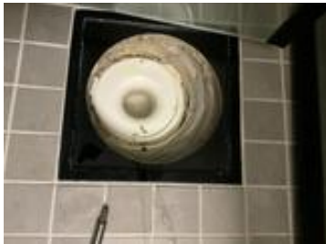
Sluk i dusj med noe synlig membran under klemring.
