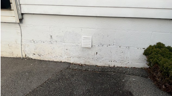
Ringmur med ventil.
