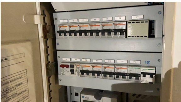
Sikringsskap med automatsikringer.
