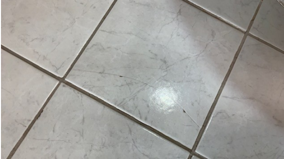
Sprekk i flis på gulv.
