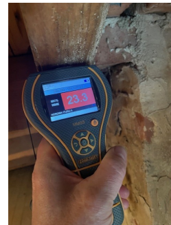
Forhøyet fuktnivå i bjelke ved pipe.
