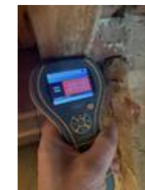
Forhøyet fuktnivå i bjelke ved pipe.
