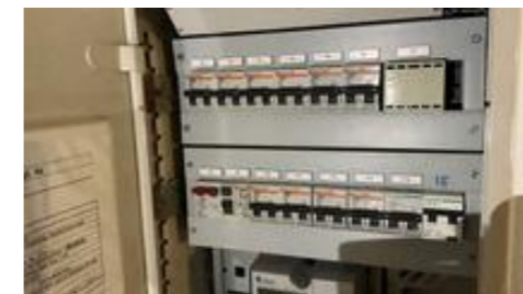
Sikringsskap med automatsikringer.
