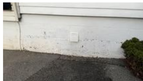
Ringmur med ventil.
