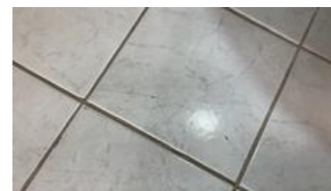
Sprekk i flis på gulv.
