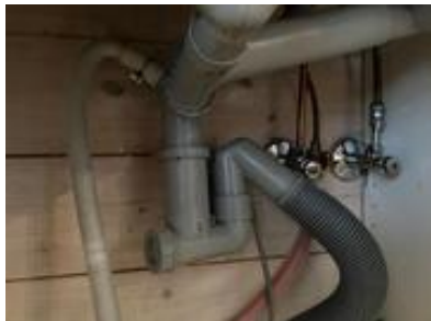
Røropplegg i skap under vask
