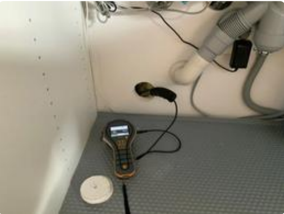
Fuktmåling fra kjøkken i dusjonens område.
