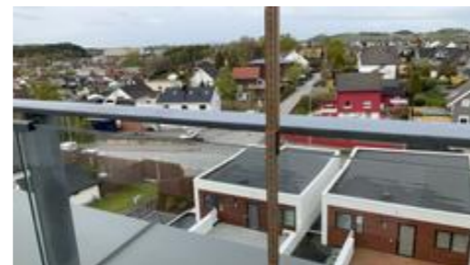
Rekkverk på balkong minimum 120 cm.
