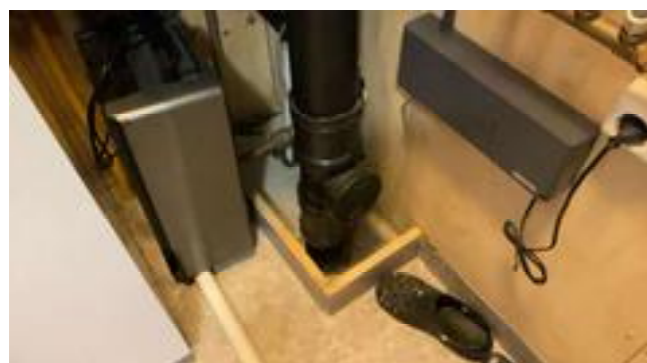
Avløpsrør i plast/PVC.
