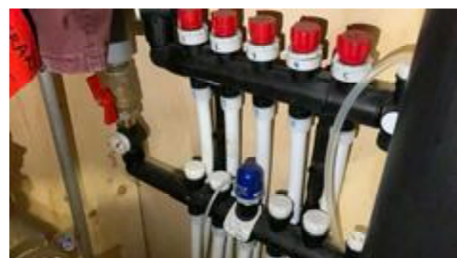
Motorer for vannbåren varme.
