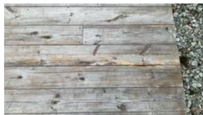
Råteskader på enkelte terrassebord
