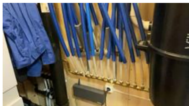
Vannfordelere/vannledninger av plast.
