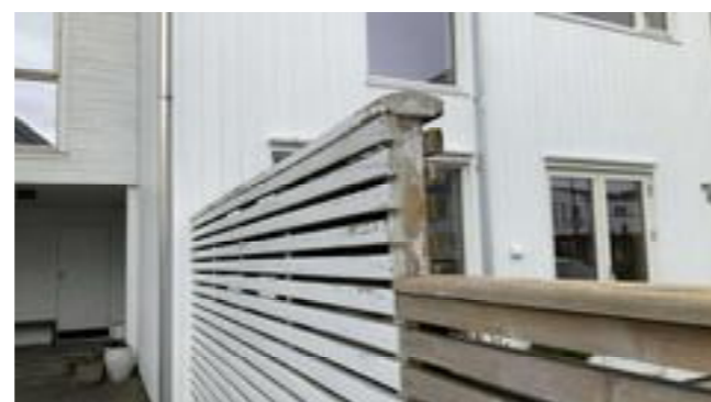
Levegg/spilevegg med malingsavflassing/magert behandlet
