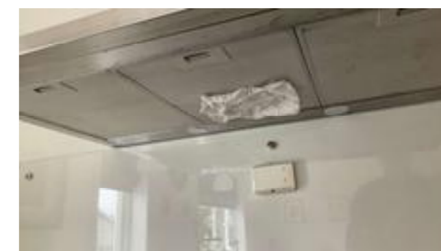
Ventilator funksjonstestet med papir.
